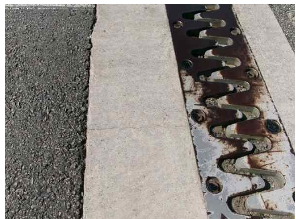
A1 후타재 균열(Cw=0.3mm미만)
