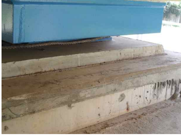
P1-Sh1 받침물탈 균열(Cw=0.3mm미만)
