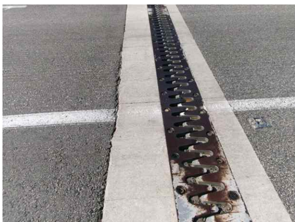
A1 후타재 균열(Cw=0.3mm미만)
